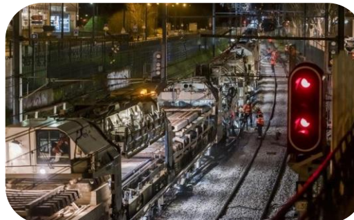
Ex : Projet EOLE - électrification Gretz - Troyes – Interconnexion Grand Paris Express – projets d'infrastructures destinés à accueillir les nouveaux matériels roulants (RER NG, Smartilien)
